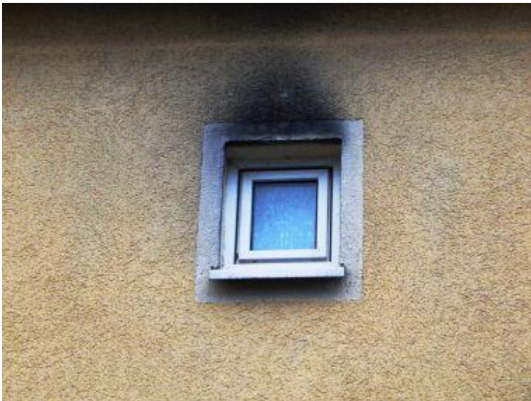
Detail aus Redwitz: Schießscharte (durch Dämmplatten) mit Pulverdampf (Algen bzw. Schimmel mit Anlagerungen). Bild: Konrad Fischer
