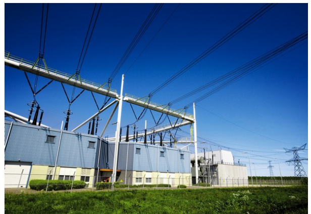
An solchen Umspannstationen entscheidet sich, welcher Strom an Ende ins Netz kommt – und hier sitzen meist noch die vier großen Netzbetreiber an den Schalthebeln. (Foto: Tennet)
