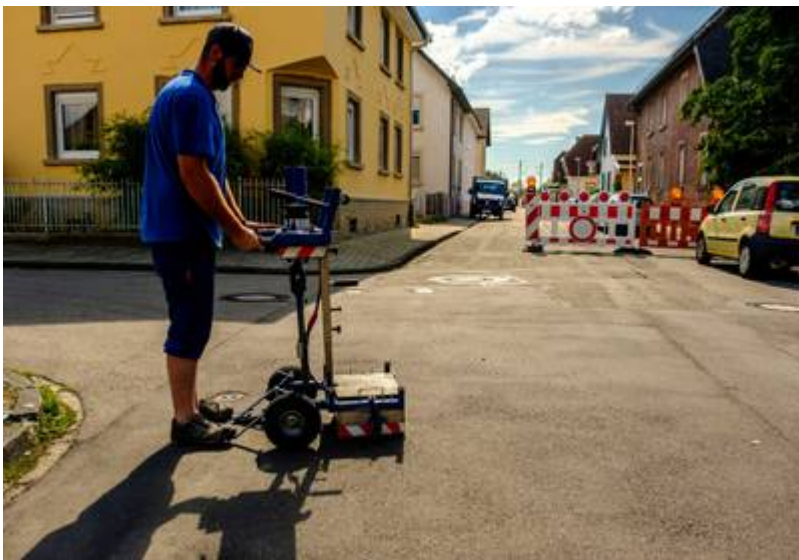
Ein Stadtwerker überprüft Gas- und Wasserleitungen nach dem "Schadensereignis". Foto: Joachim E. Röttgers
