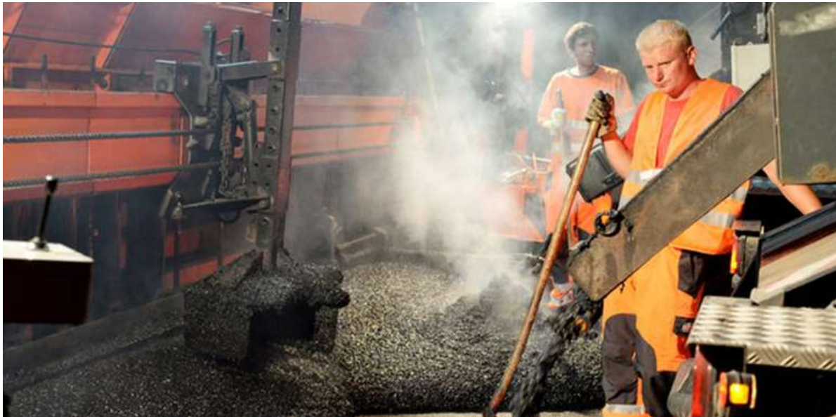
Arbeiten an der A 100 in Berlin mit ganz neuem Asphalt Foto: Matthias Balk/dpa VON CHRISTIAN RATH
